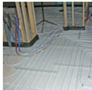
Vesikiertoinen lattialämmitys säästää energiaa, sillä tasaisen lämmönjaon ansiosta sisälämpötilaa voidaan laskea ja saavuttaa näin kustannussäästöä. Kuva Motiva Oy
