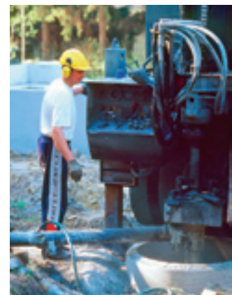
Maaperän pintakerrokseen tai vesistöön varastoitunutta aurinkoenergiaa kerätään vaak- tai pystyputkituksella, jossa kiertää jäätymätön liuos. Maalämpöpumppu mitoitetaan kattamaan joko talon koko lämmitystarve tai puolet rakennuksen mitoitustehosta, jolloin se riittää 85–95 prosenttiin pientalon vuotuisesta lämmitysenergiatarpeesta. Kuva Motiva / Vesa Erkkilä
