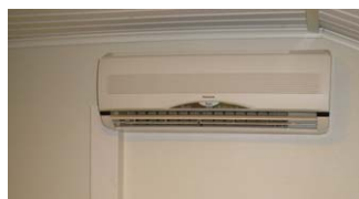
Ilmalämpöpumpun sisäyksikön johdot ja putket ovat koteloitu siististi.
